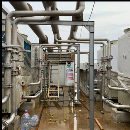
Instalasi Pipa Chiller SUS
